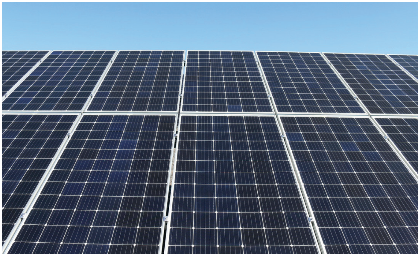
La Asociación El Saliente ha instalado placas solares en algunos de sus centros y sedes.
