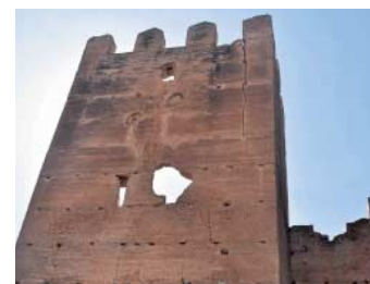
La imagen del daño El orificio es mayor que las troneras de la fortificación
